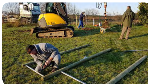
Montage des barres fixes et forage des trous de fondation (photos M.V.)
